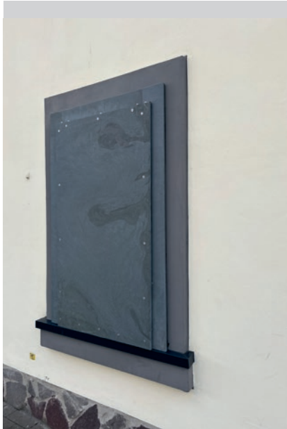
Beispiel des eingebauten Flutschutzsystem an einem Fenster mit eingesetzter Schutzplatte
